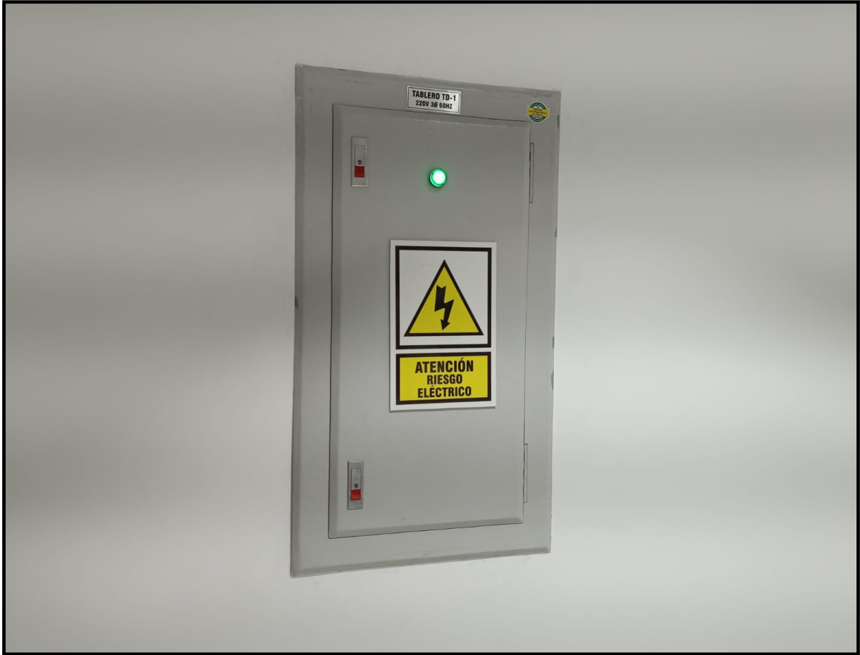
Foto 13: Tablero eléctrico TD-1
