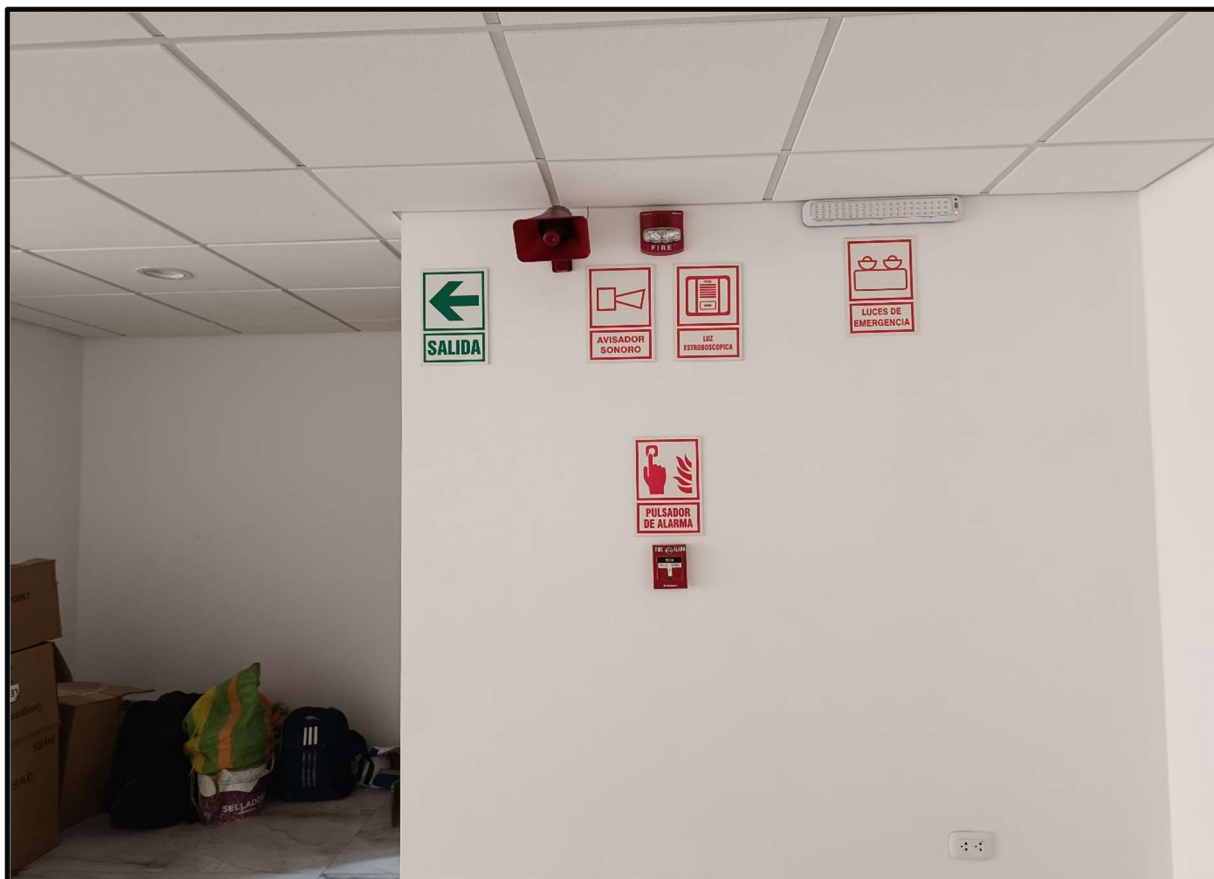
Foto 09: Señalizaciones, pulsador de alarma, luz estroboscópica, avisador sonoro y luces contra incendio en corredor eje D.
