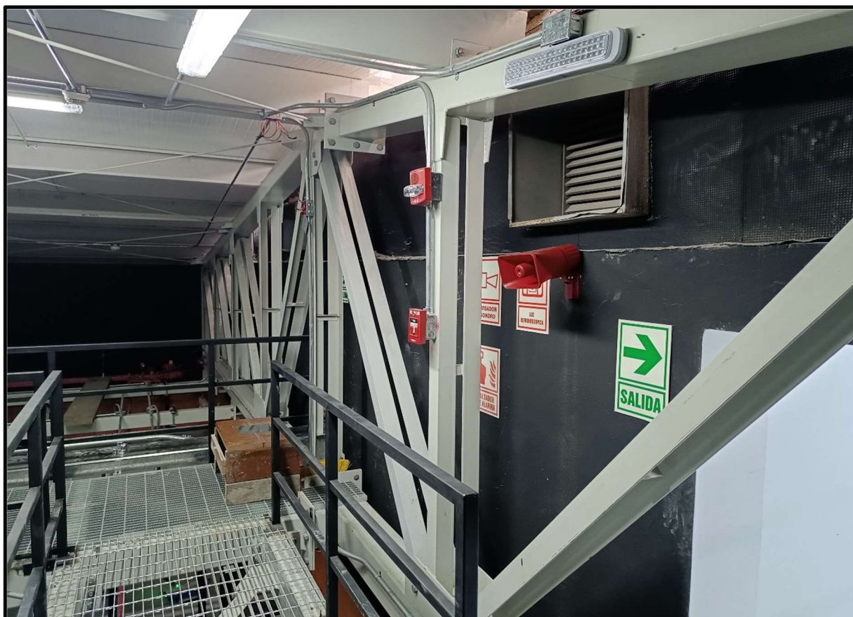
Foto 33: Señalizaciones, pulsador de alarma, luz estroboscópica, avisador sonoro y luces contra incendio en pasarela de servicio
