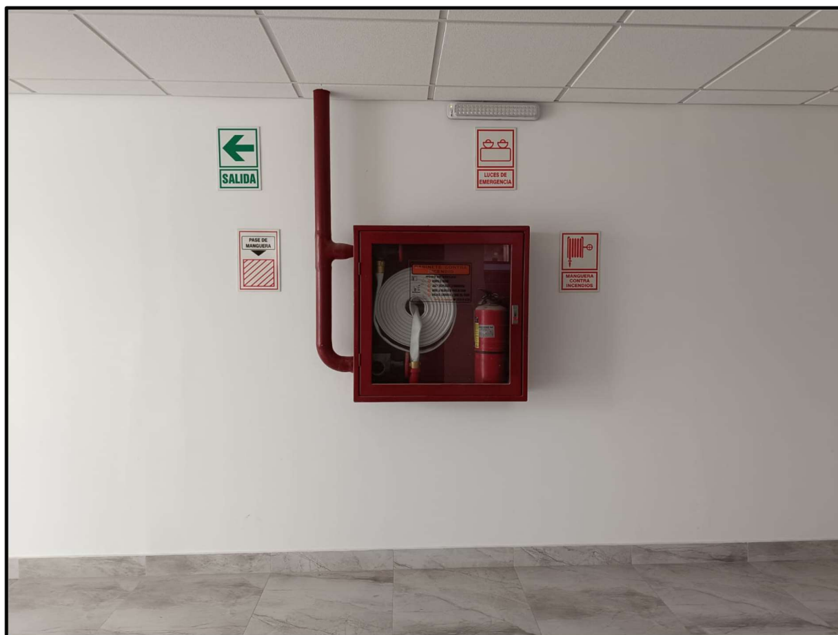
Foto 11: Gabinete contra incendio en corredor eje D
