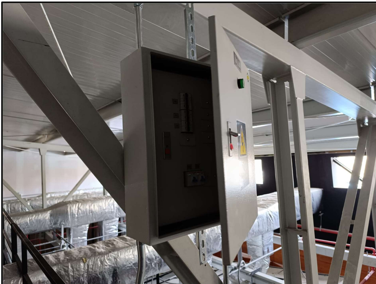
Foto 35: Tablero eléctrico en pasarela de servicio
