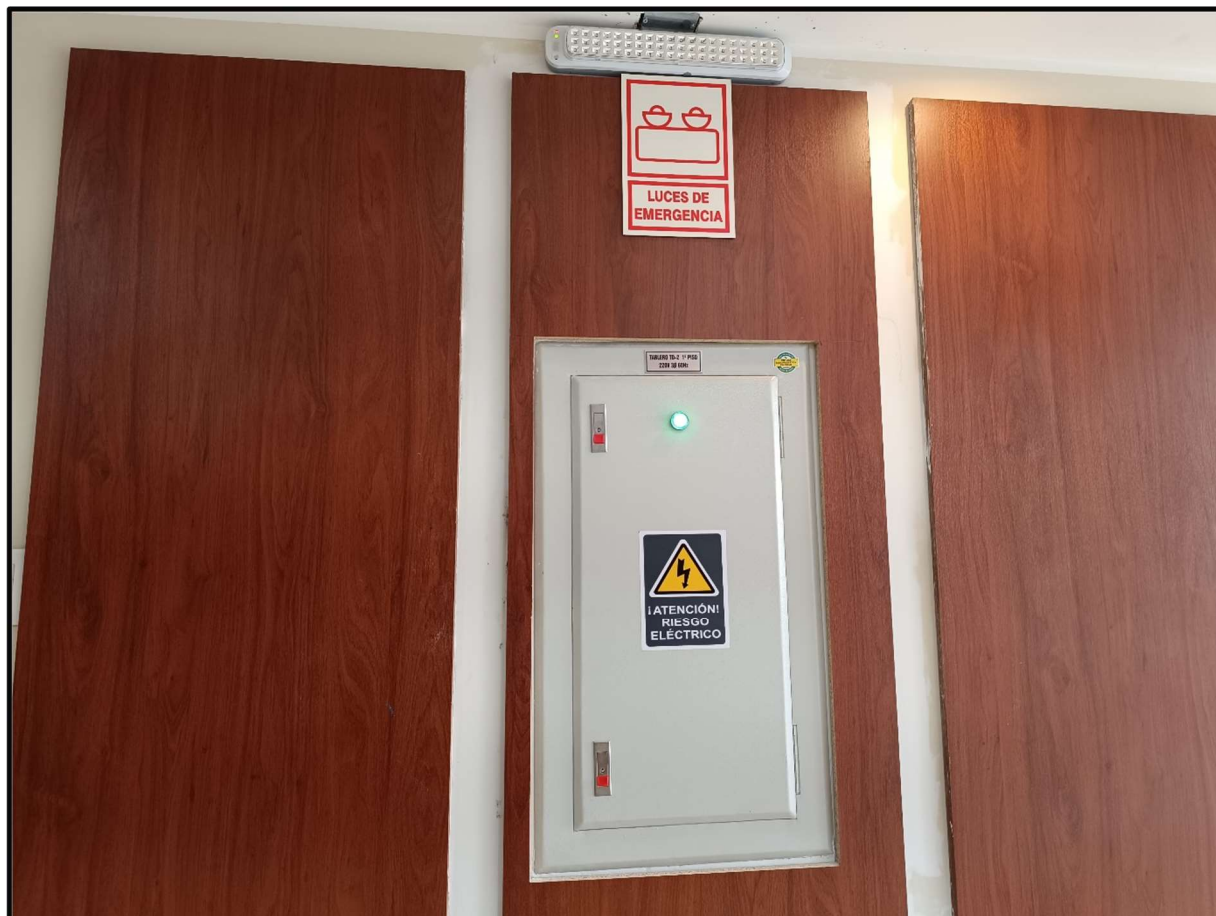
Foto 24: Tablero eléctrico TD-2 en corredor 02 VALORIZACIÓN MENSUAL DE OBRA N° 10 – SETIEMBRE 2024
