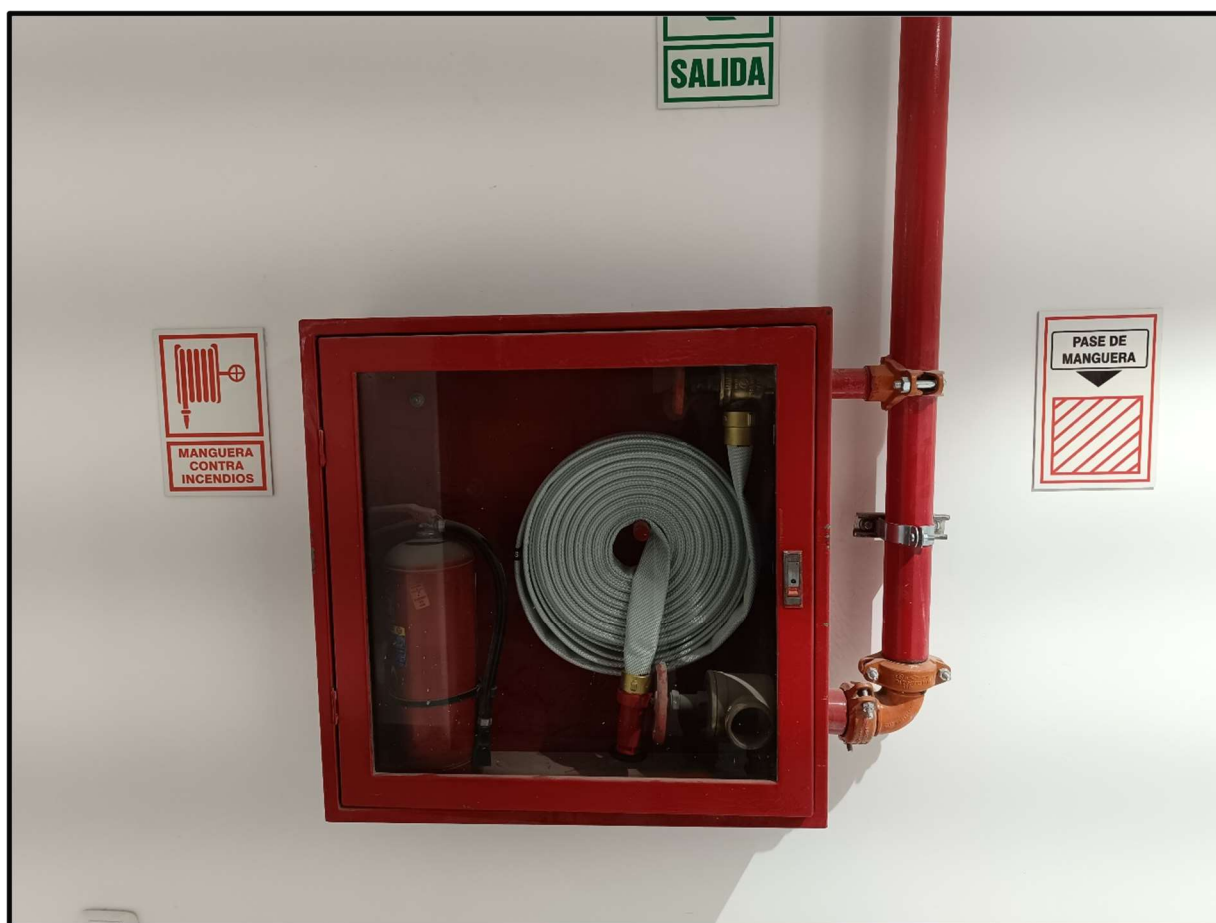
Foto 12: Gabinete contra incendio en corredor eje B
