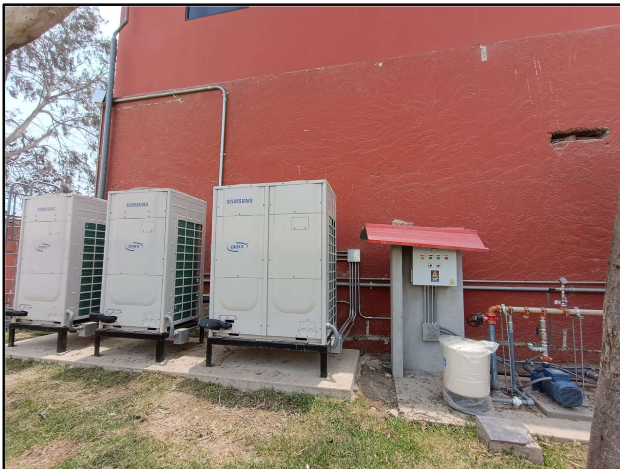
Foto 41: Unidades condensadoras y sistema eléctrico
