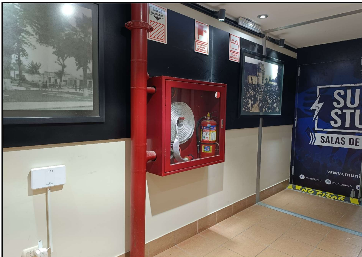
Foto 23: Gabinete contra incendio en corredor 02
