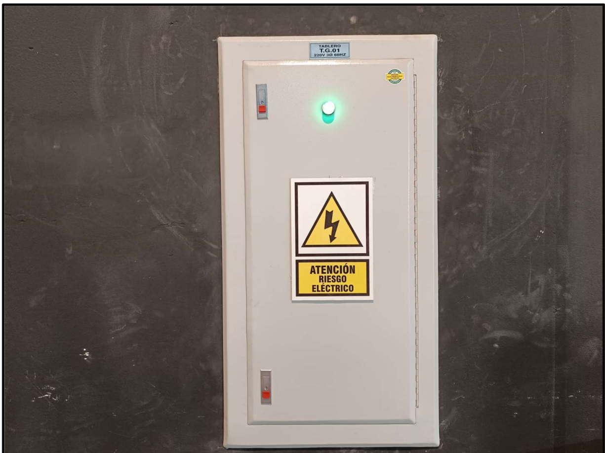
Foto 16: Tablero eléctrico TG-1 para escenario
