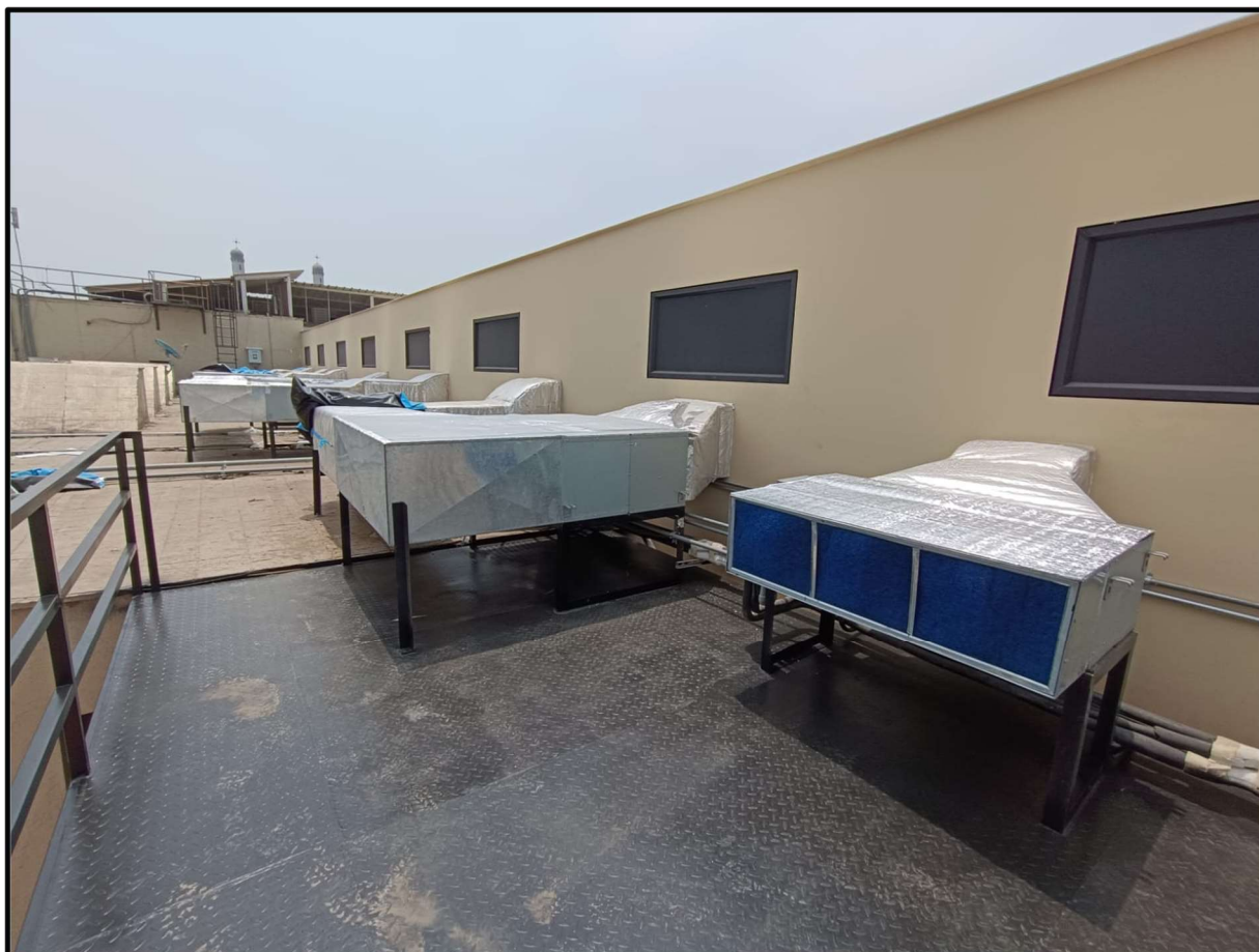
Foto 39: Vista exterior 01 tercer nivel, unidades evaporadoras y exhutorios
