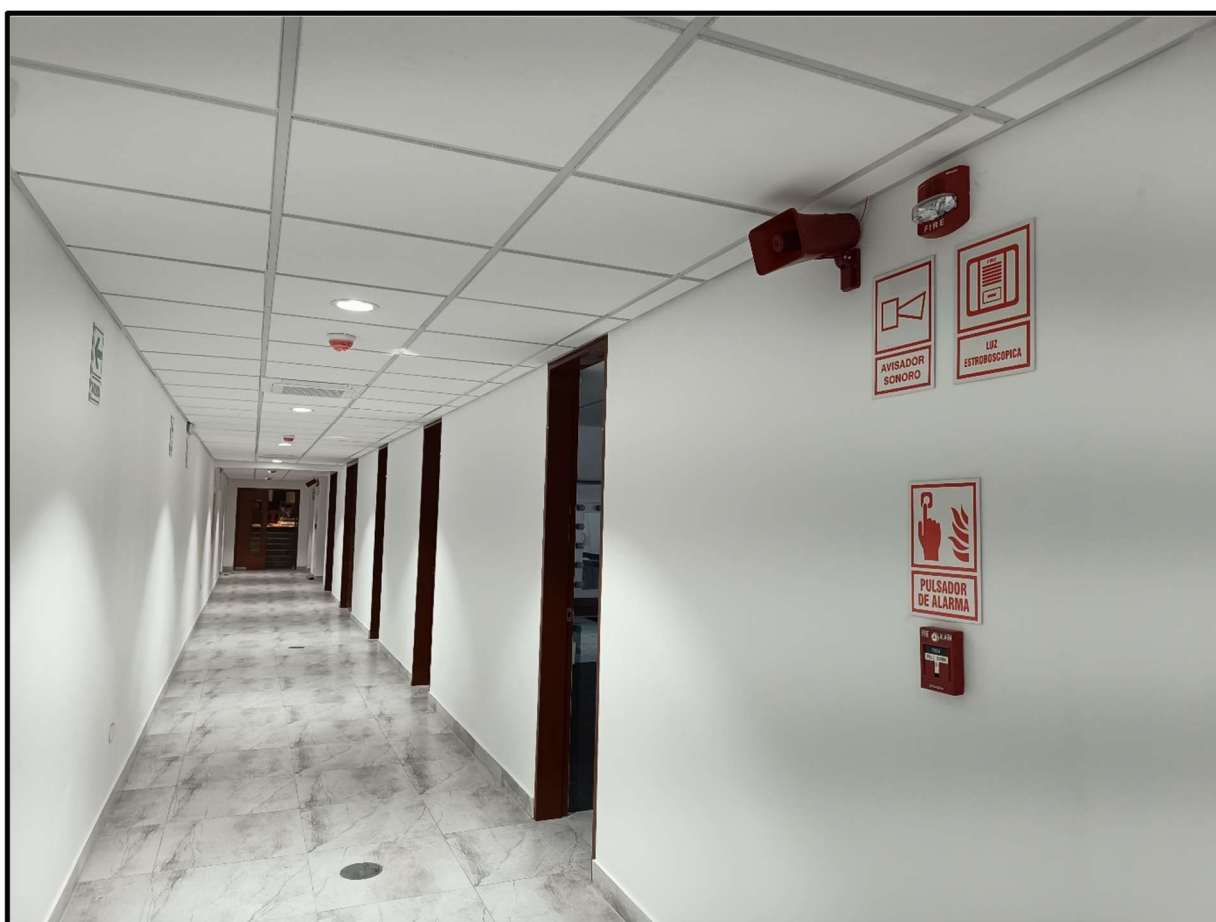
Foto 08: Señalizaciones, pulsador de alarma, luz estroboscópica y avisador sonoro, en corredor técnico N° 01
