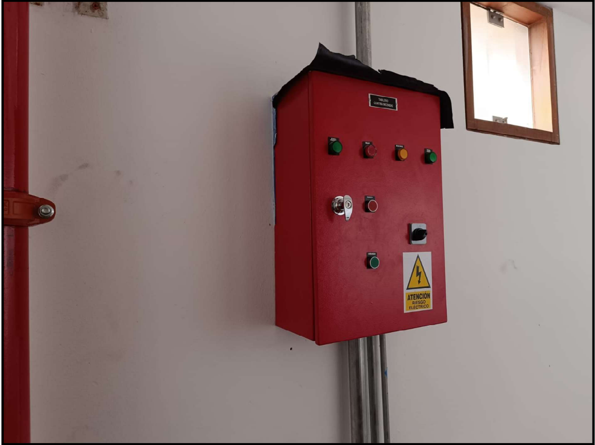
Foto 15: Tablero de Bomba
