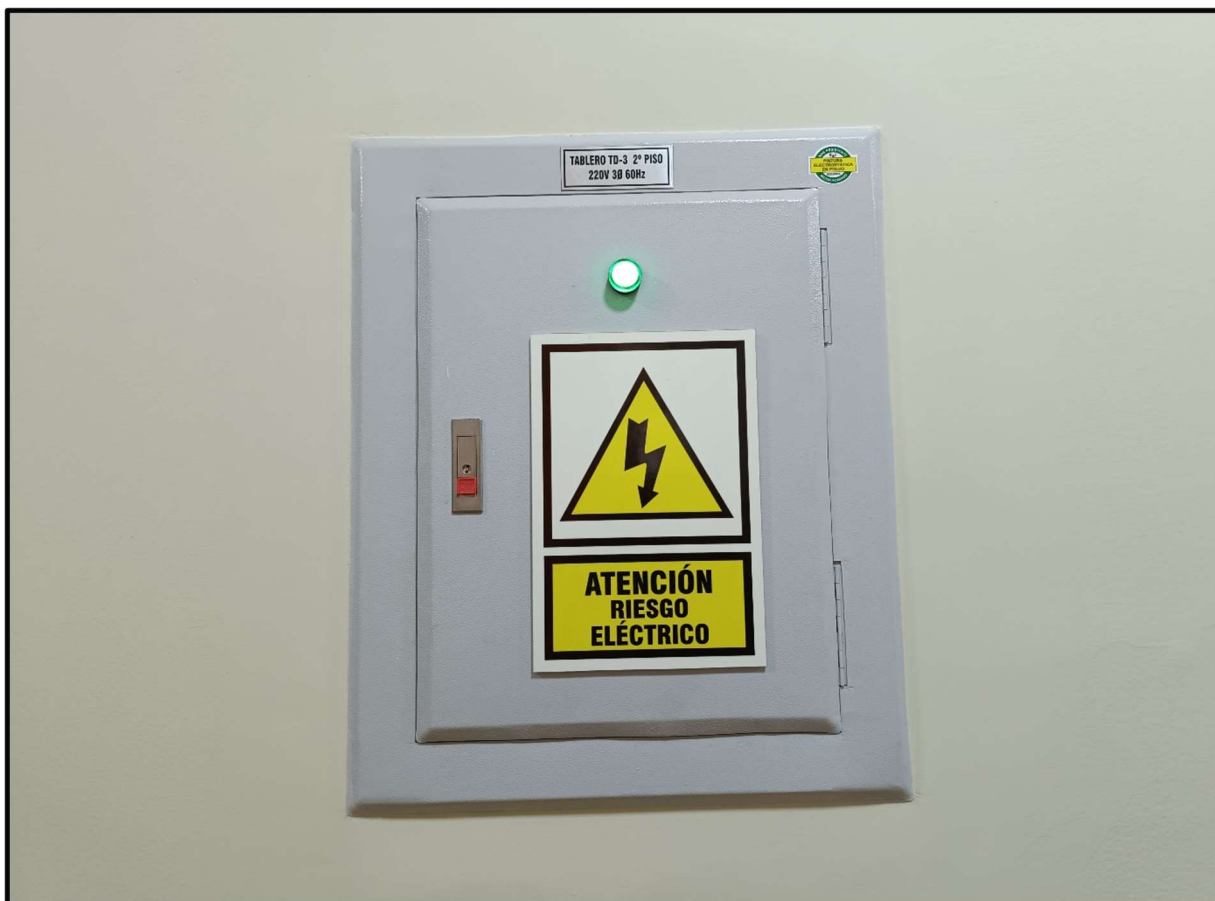
Foto 26: Tablero eléctrico TD-3 en corredor 03
