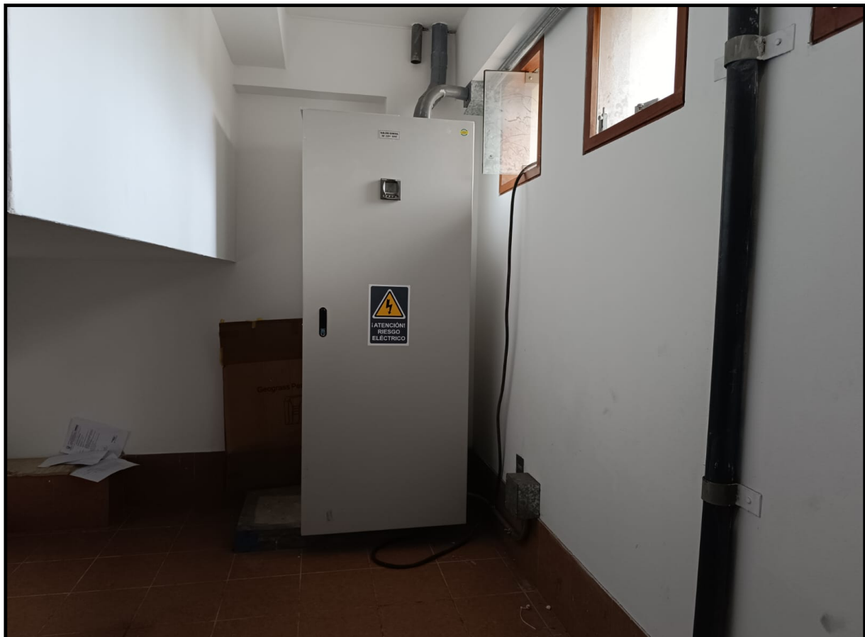
Foto 14: Tablero eléctrico General TG
