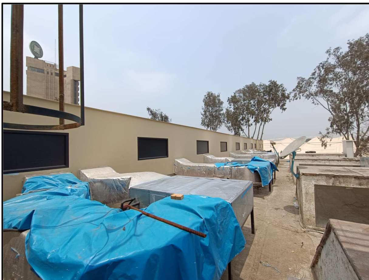
Foto 40: Vista exterior 02 tercer nivel, unidades evaporadoras y exhutorios
