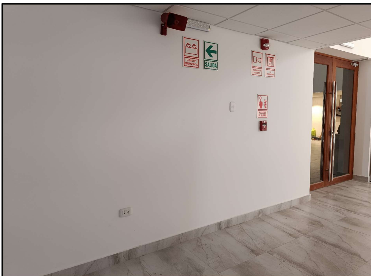
Foto 10: Señalizaciones, pulsador de alarma, luz estroboscópica, avisador sonoro y luces contra incendio en pre foyher.
